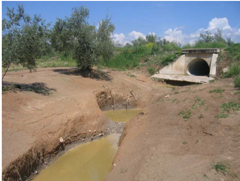
Foto 2.- Punto de encuentro del tratamiento con la carretera: situación de inicial (Abril 2007).
