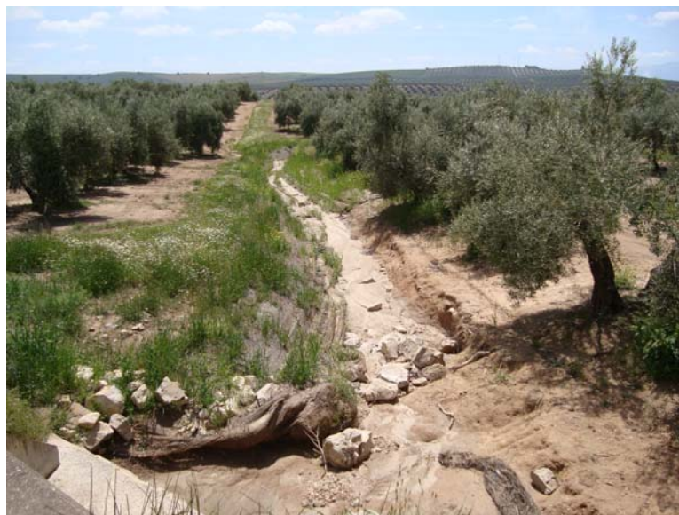
Foto 5.- Rip-rap destruido por las tormentas y estado general de la embocadura en abril de 2008.
