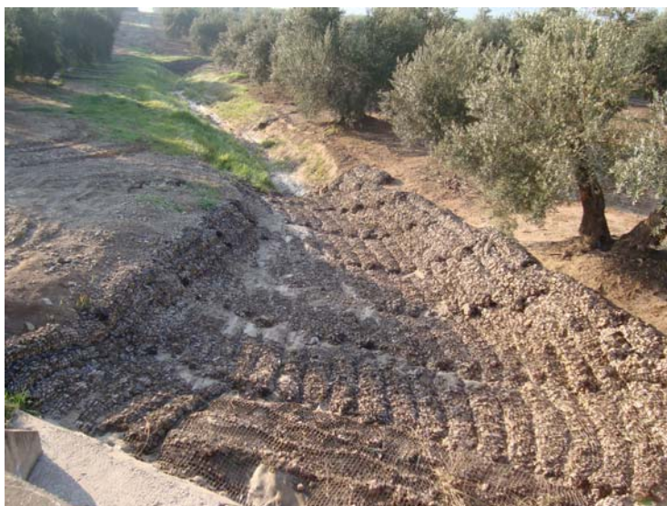
Foto 7.- Vista de la embocadura en febrero 2009, tras fuertes aguaceros.
