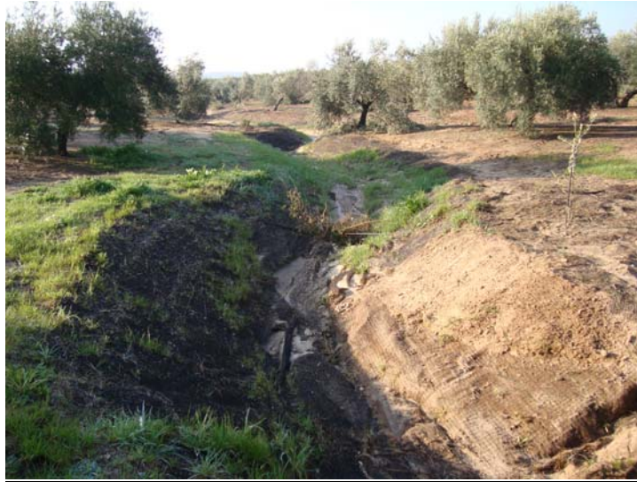
Foto 8.- Tratamiento con Bonmat mini K, en primer término a izquierda, y 2K3R, a derecha.
